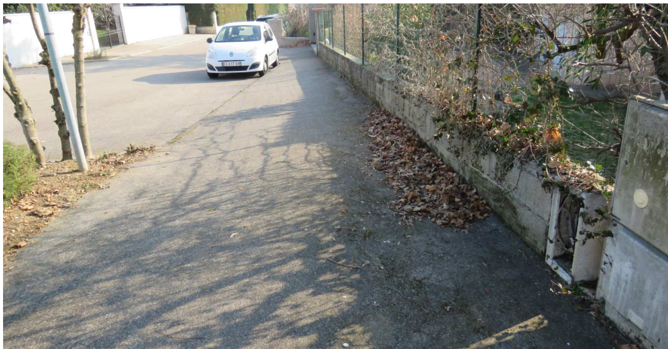
N°11 : amoncellement et développement de végétaux au droit du trottoir et du muret de clôture du lot n°5 participant à la dégradation du béton bitumineux
