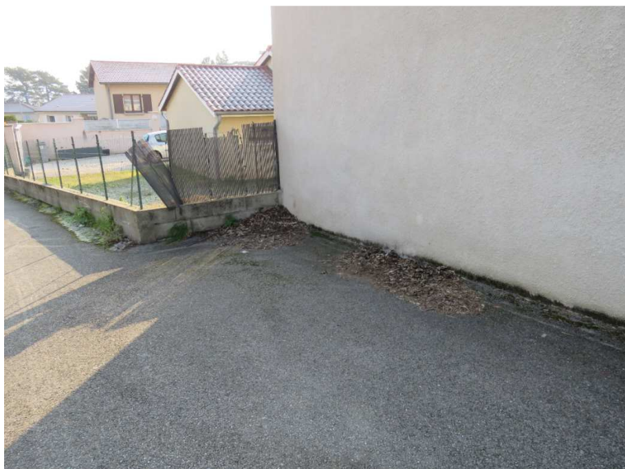
N°2 : amoncellement de végétaux au droit du mur du garage de lot n°47 participant à la dégradation du béton bitumineux
