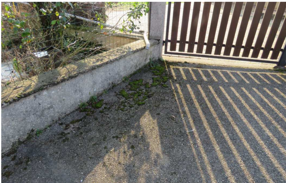
N°8 : développement de végétaux et dégradation du béton bitumineux au droit du muret de clôture du lot n°20 et à l'entrée du lot n°21
