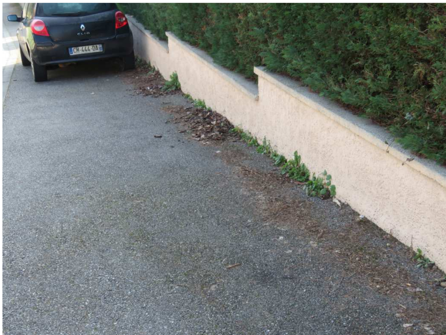
N°5 : amoncellement et développement de végétaux au droit du muret de clôture du lot n°23 participant à la dégradation du béton bitumineux
