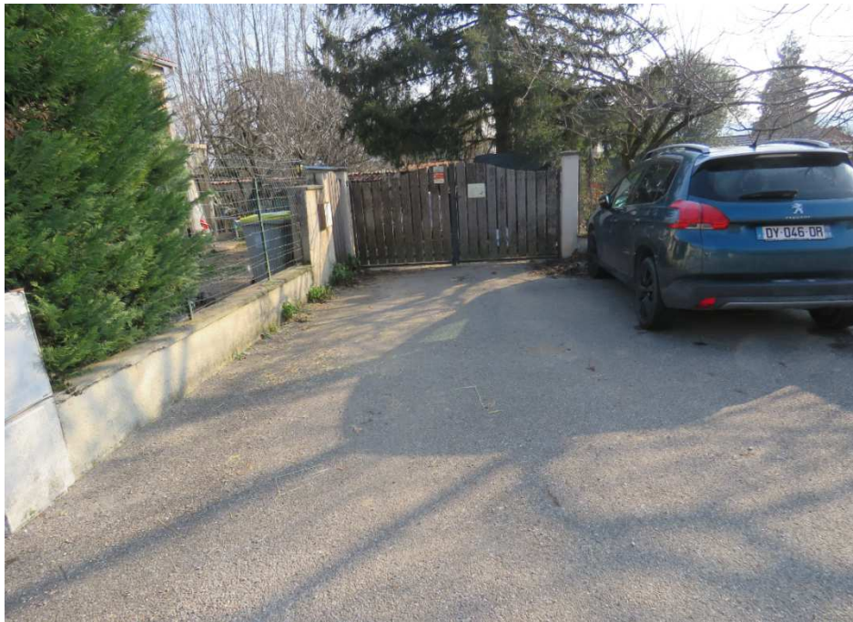
N°7 : développement de végétaux au droit du muret de clôture du lot n°20 participant à la dégradation du béton bitumineux
