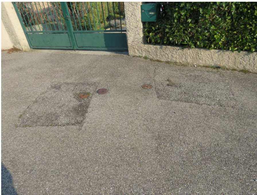
N°11 : fissures de retrait autour d'une des deux réparations de bouche à clé au droit du lot n°42 (voirie des lots n°39 à n°47) - Ouverture de 0,5 à 1 mm avec développement de végétation. Fermetures des réparations mal réalisées: mauvais compactage et enrobé à froid.
