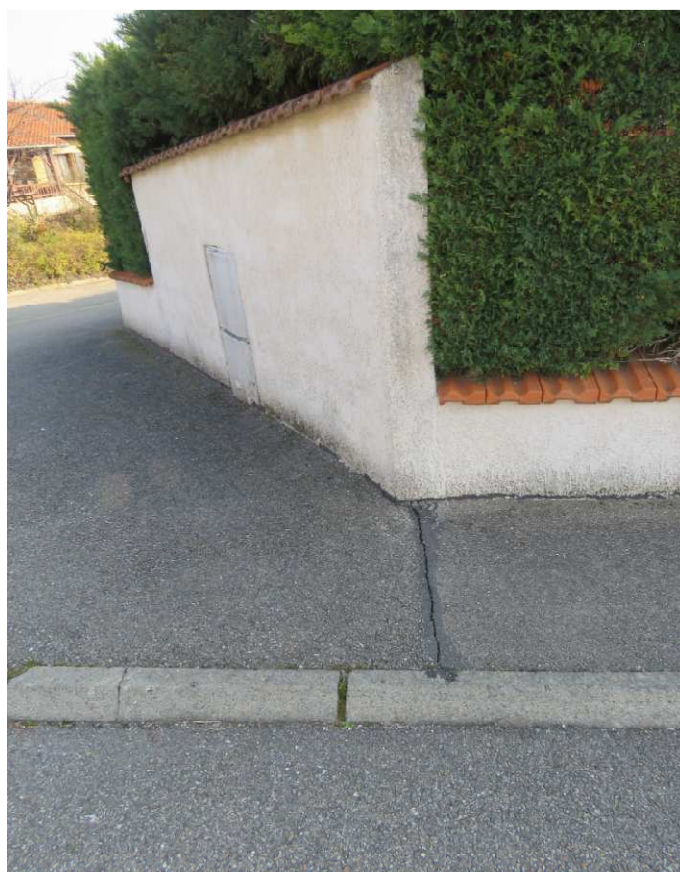
N°8 : fissure de retrait du trottoir le long d'une reprise de réalisation du béton bitumineux au droit de lot n°47 et de l'entrée de le voirie des lots n°39 à n° 47 - Ouverture de 5 mm
