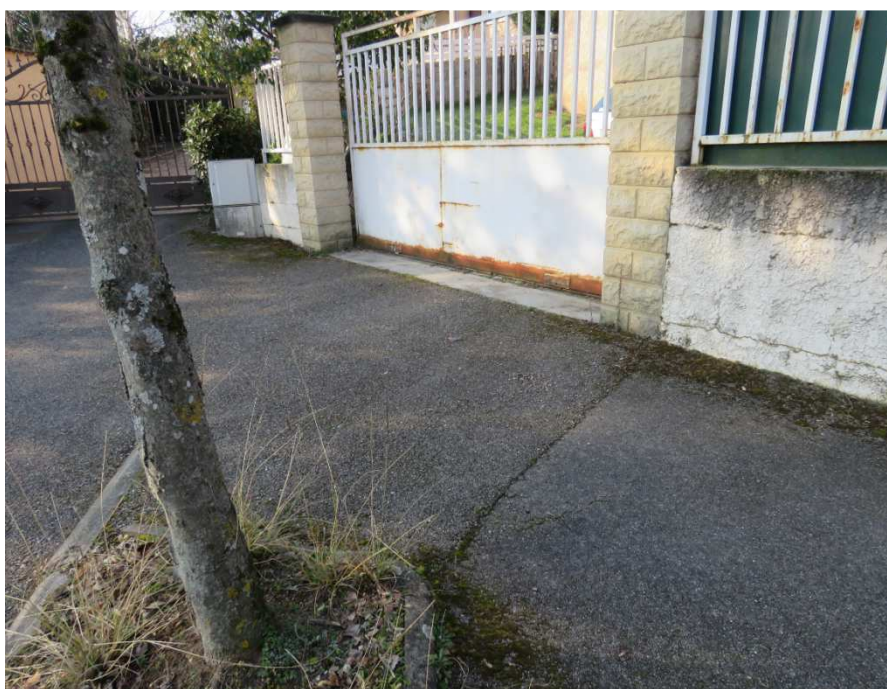
N°6 : fissure de retrait sur le trottoir le long d'une reprise de réalisation du béton bitumineux au droit de lot n°38- Ouverture de 0,5 a 2 mm.
