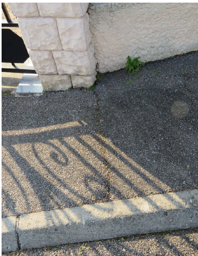
N°14 : fissure sur trottoir de retrait le long d'une reprise de réalisation du béton bitumineux au droit de lot n°34 (voirie des lots n°28 à n°34) - Ouverture de 0,5 à 1 mm.
