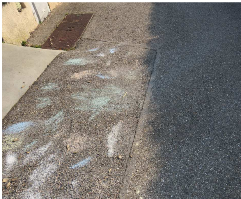
N°10 : fissure de retrait le long d'une reprise de réalisation du béton bitumineux au droit de lot n°40 (voirie des lots n°39 à n°47) - Ouverture de 1à 2 mm
