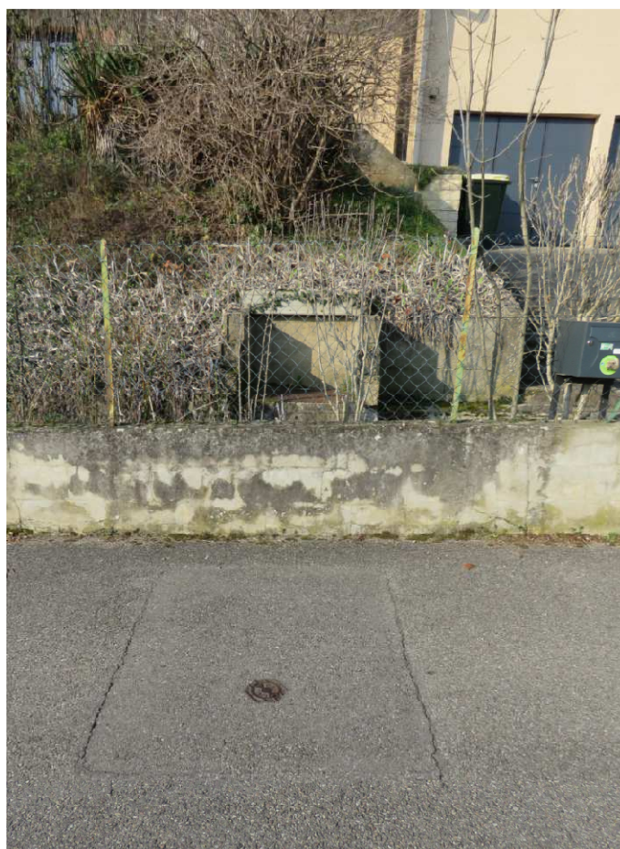
N°2 : fissures de retrait autour d'une reparation d'une bouche à clé au droit du lot n°27 - Ouverture de 1 à 2 mm
