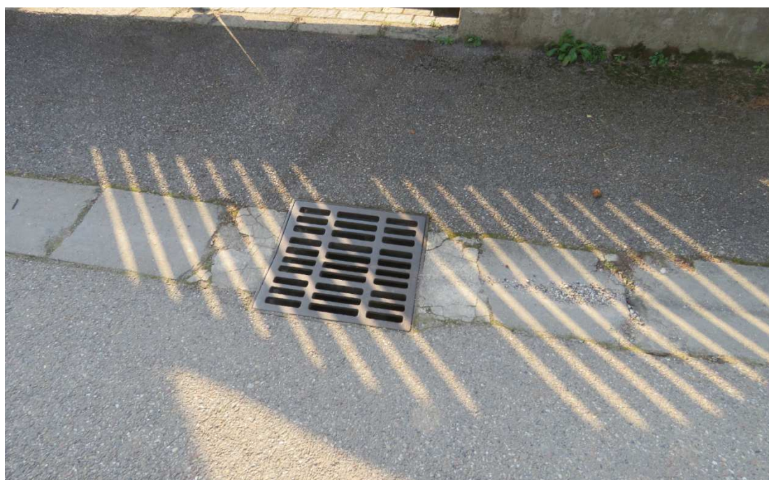
N°20 : dégradations ( fissurations et éclatements) du béton de jonction entre les caniveaux au droit d'un regard à grille au niveau du lot n°22 (voirie des lots n°14 a n°25)
