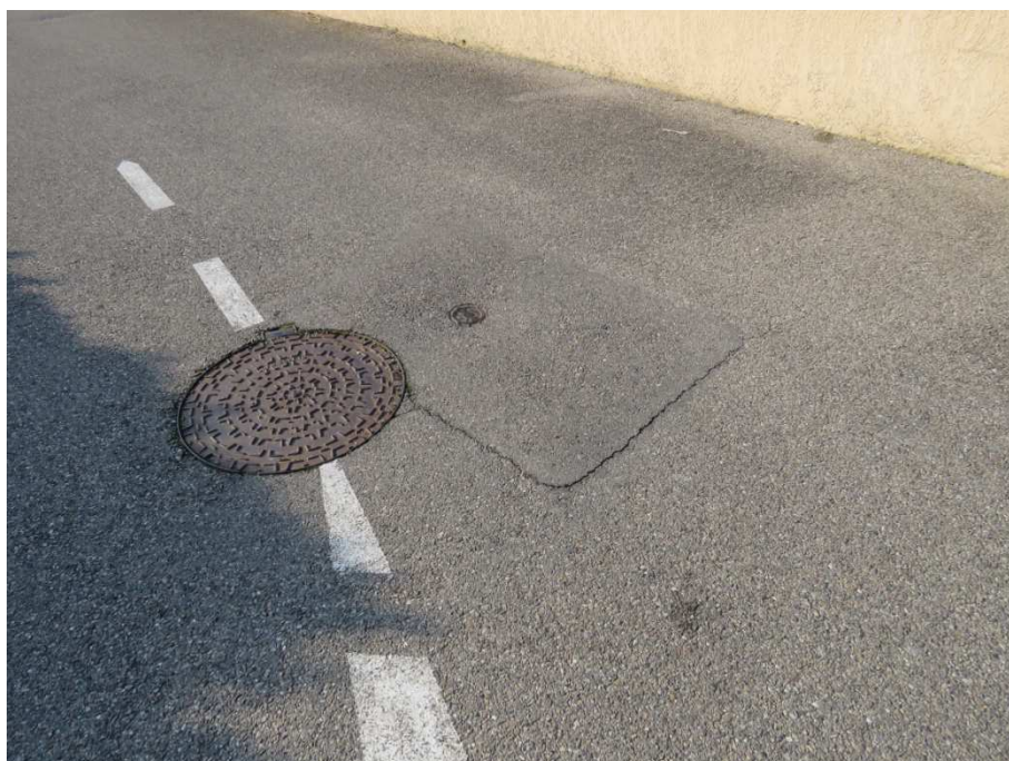
N°1 : fissures de retrait autour d'une reparation d'une bouche à clé entre les lots n°25 et n°26 - Ouverture de 1 à 3 mm
