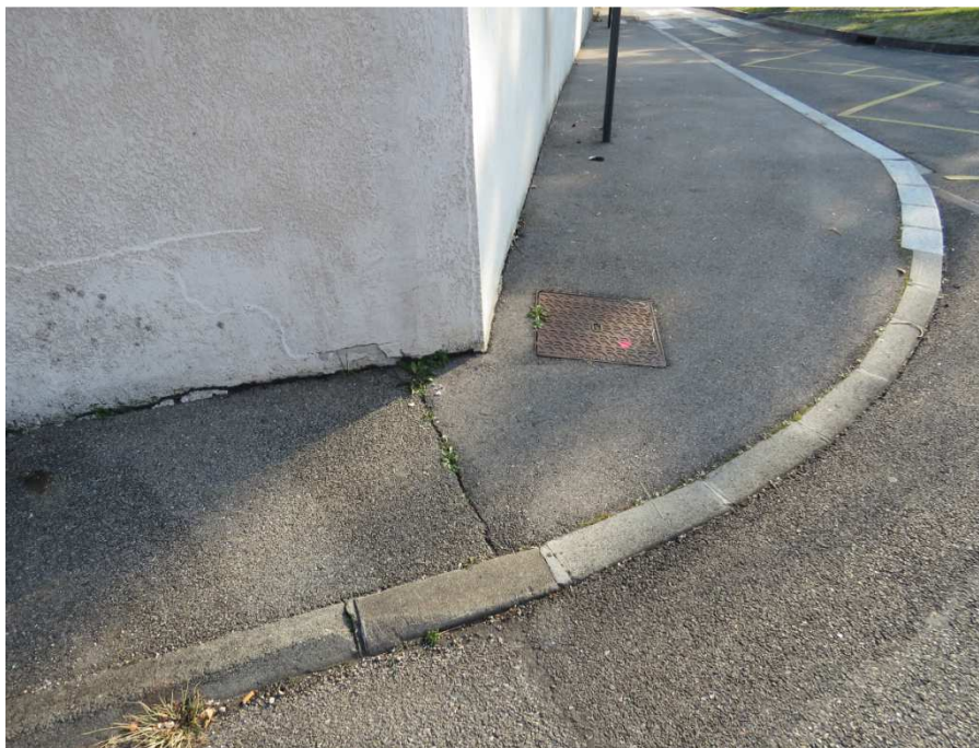
N°7 : fissure de retrait du trottoir le long d'une reprise de réalisation du béton bitumineux au droit de lot n°47 entrée du lotissement sur le trottoir - Ouverture de 5 mm avec développement de végétation.
