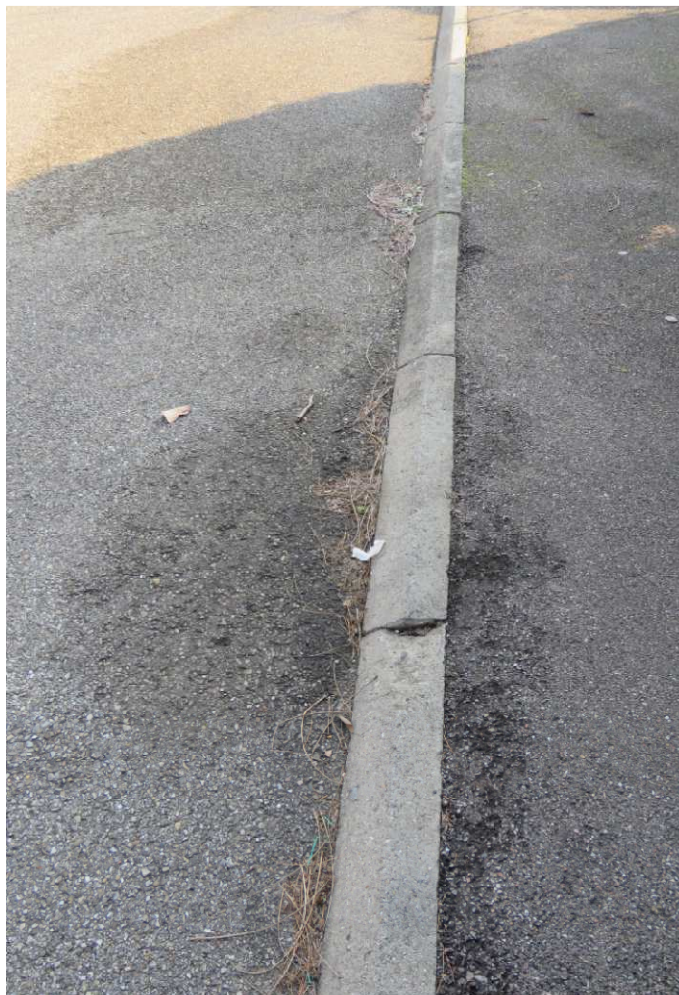
N°15 : Taches d'huile et dégradations du béton bitumineux sur chaussée et trottoir au droit de lot n°33 (voirie des lots n°28 à n°34) -
