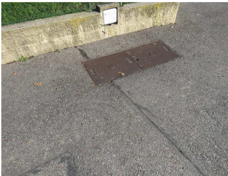
N°21 et n°22 : fissurations sur chaussé de retrait le long des reprises de réalisation du béton bitumineux concernant la création du raccordement ENEDIS de la propriété RONZON au droit du lot n°15 et de l'accès à la propriété RONZON (voirie des lots n°14 à n°25) - ouverture de 0,5 à 1 mm.
