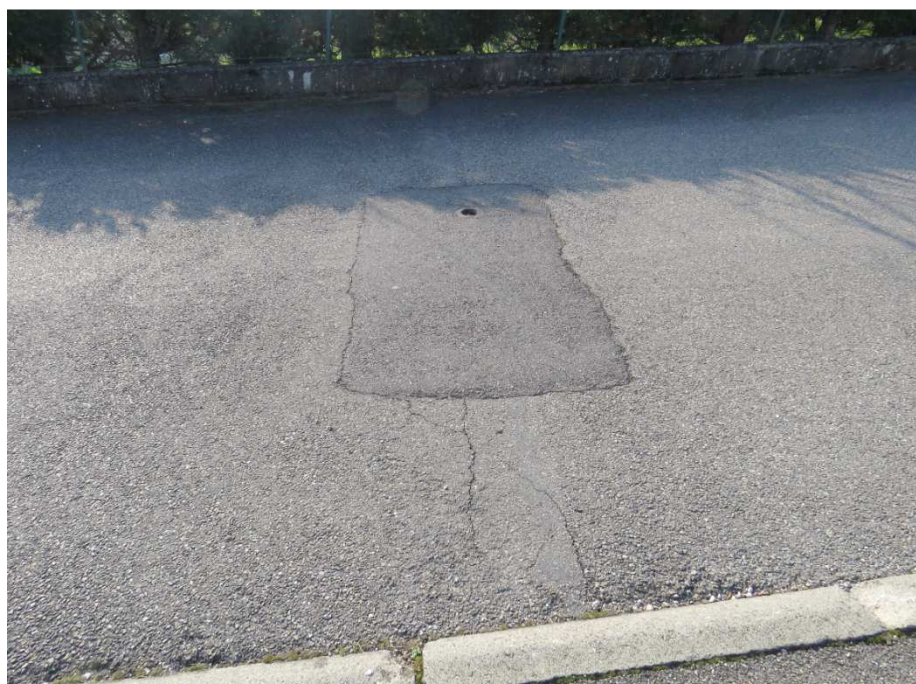
N°24 : fissures de retrait autour d'une réparation d'une bouche à clé et développement de fissures entre la réparation et la bordure de trottoir entre les lots n°25 et n°14 - Ouverture de 2 à 4 mm
