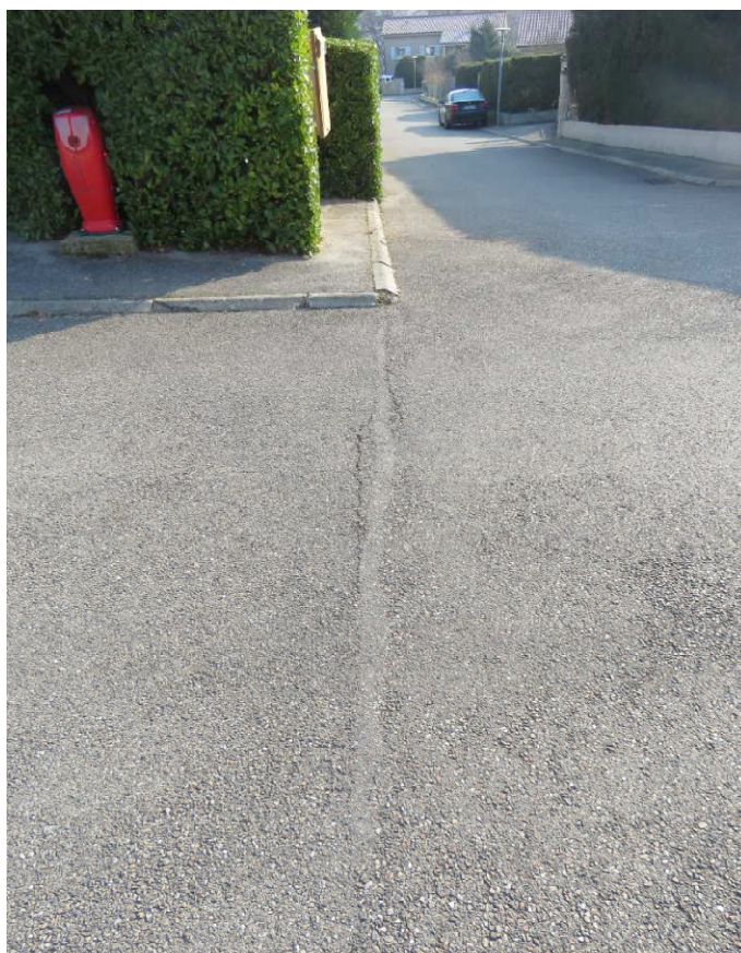
N°4 : fissure de la chaussée de retrait le long d'une reprise de réalisation du béton bitumineux au droit du transformateur sur la moitié de la largeur de la chaussée- Ouverture de 0 à 2 mm.
