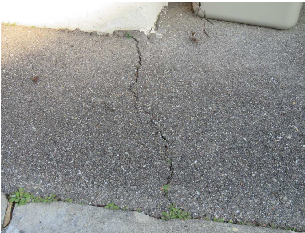
N°23 : fissure sur trottoir de retrait du béton bitumineux au droit des lots n°15 et n°16 (voirie des lots n°14 à n°25) - Ouverture de 2 à 4 mm avec début de développement de la végétation.
