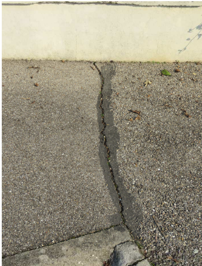
N°19 : fissure sur trottoir de retrait le long d'une reprise de réalisation du béton bitumineux au droit du lot n°17 (voirie des lots n°14 à n°25) - Ouverture de 5 à 6 mm.
