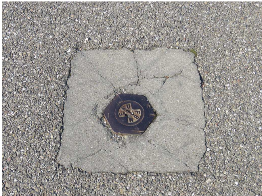
N°27 et n°28 : dégradations ( fissurations et éclatements) du mortier de scellement des bouches au niveau des lots n°1 et n°5
