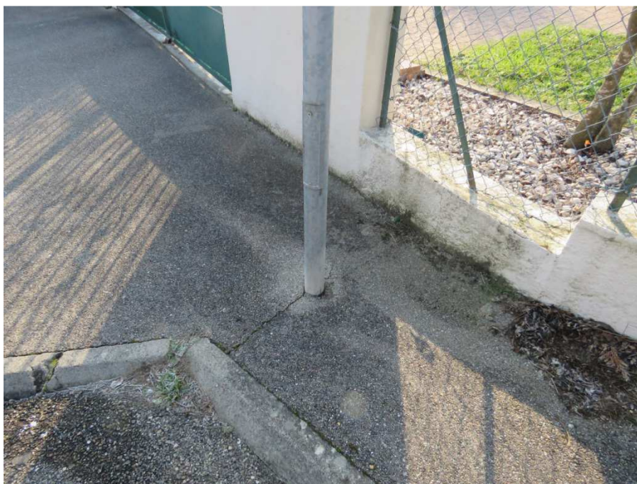
N°16 : fissure sur trottoir du béton bitumineux au droit de lot n°32 (voirie des lots n°28 à n°34) - Ouverture de 1 à 2 mm.
