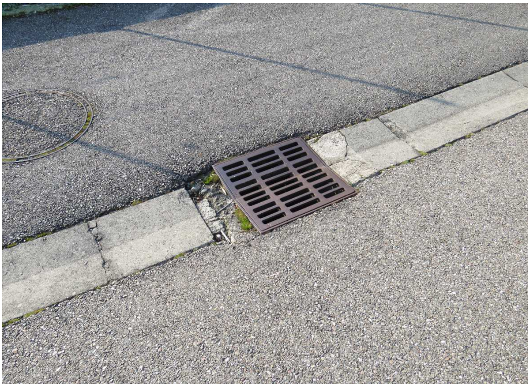
N°13 : dégradations ( fissurations et éclatements) du béton de jonction entre les caniveaux au droit d'un regard à grille au niveau des lots n°40 et n°46 (voirie des lots n°39 à n°47)
