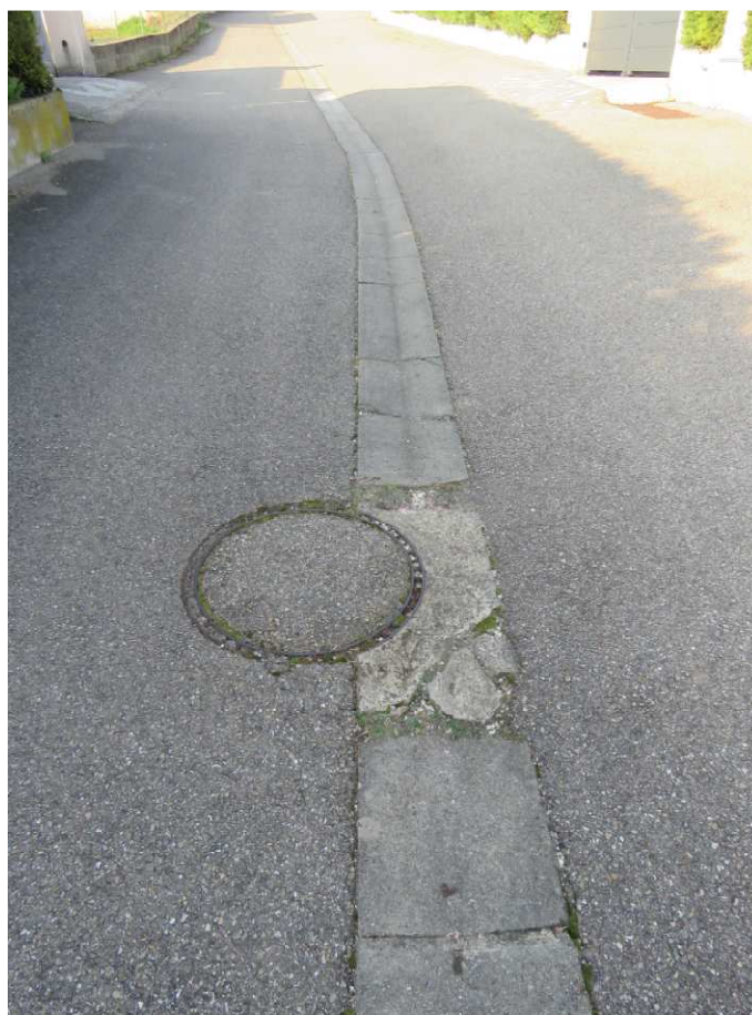
N°12 : dégradations ( fissurations et éclatements) du béton de jonction entre les caniveaux au droit d'un regard au niveau des lots n°41 et n°45 (voirie des lots n°39 à n°47)
