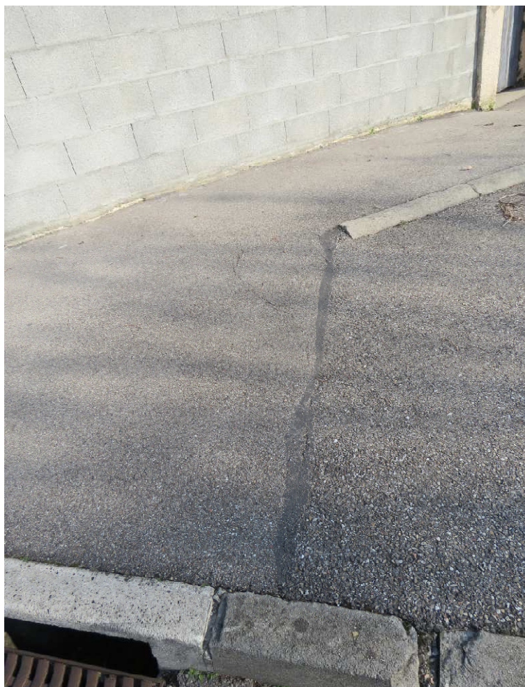
N°30 : fissure de retrait le long d'une reprise de réalisation du béton bitumineux sur le trottoir du chemin des Ferratières au droit du lot n°5 à l'entrée du lotissement accompagnée d'une fissure de tassement - Ouverture de 0,5 à 1 mm Ne concerne pas le lotissement à priori.
